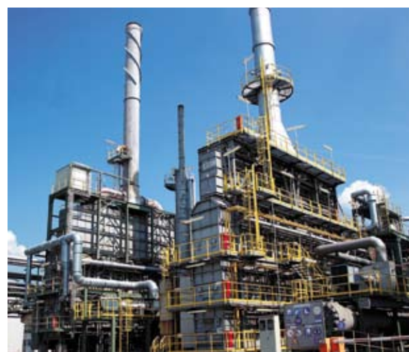
Modern und leistungsfähig: Der Spaltofen von VESTOLIT im Chemiapark Marl.
